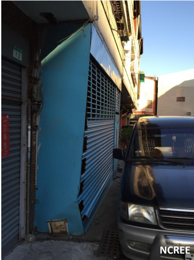
房屋之鐵捲門受差異沉陷造成扭曲變形
